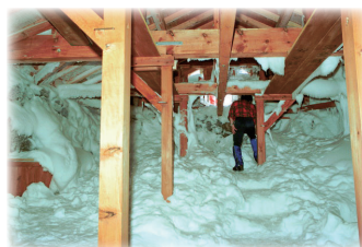
(写真9) 小屋内部・雪の吹き込み状況
